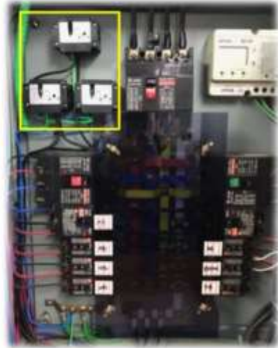
[Fire Fighting Facility_Korea] /Hạ tầng chữa cháy_Hàn Quốc/
