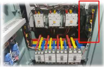
[Panel Board] [Bảng tủ điện]
